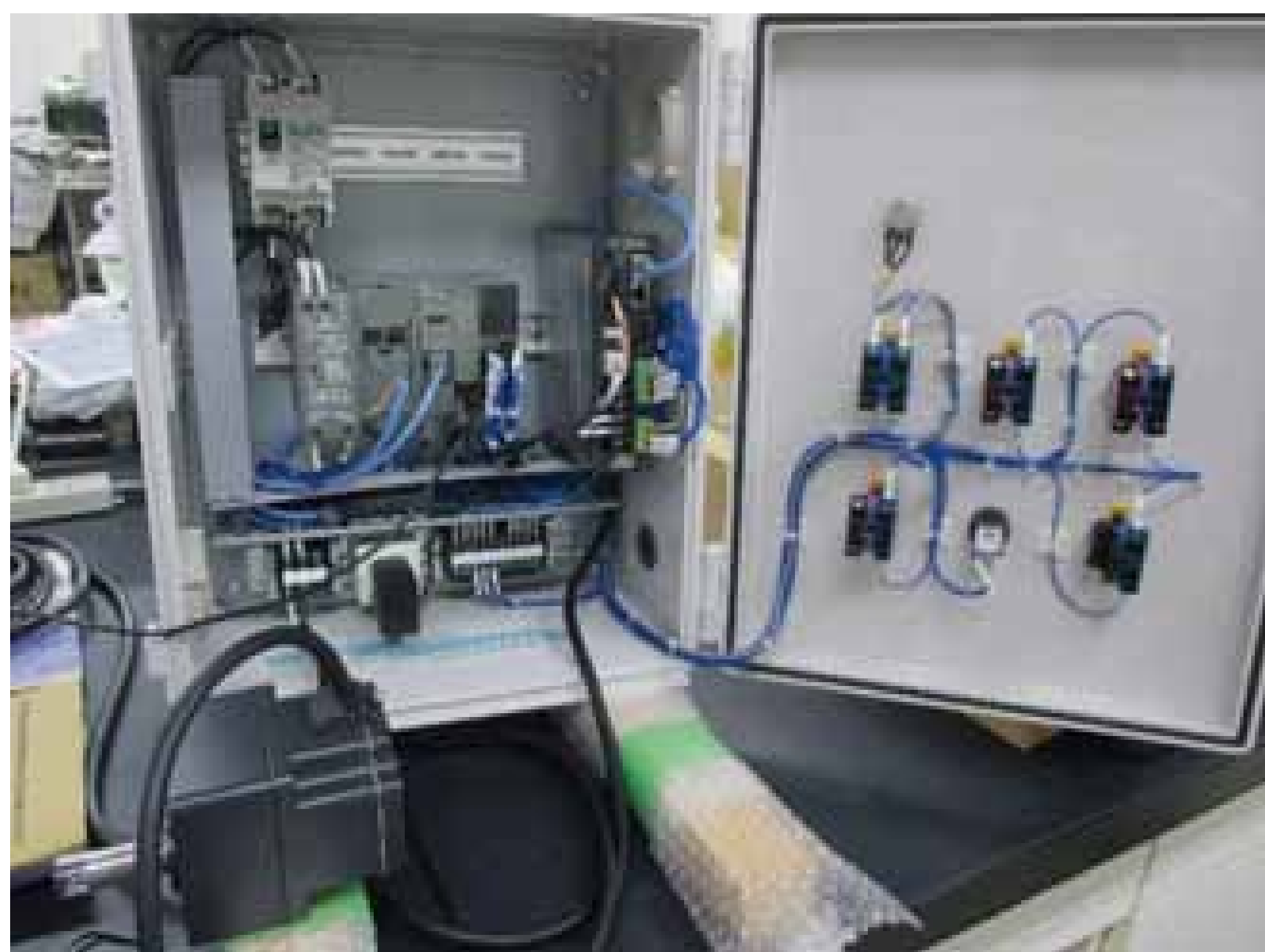
図1. 開発のシステム制御盤
