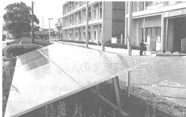
工技センターに設置された太陽光パネル。右奥に見える金属製ロッカー内に蓄電システムが収納されている—徳島市
