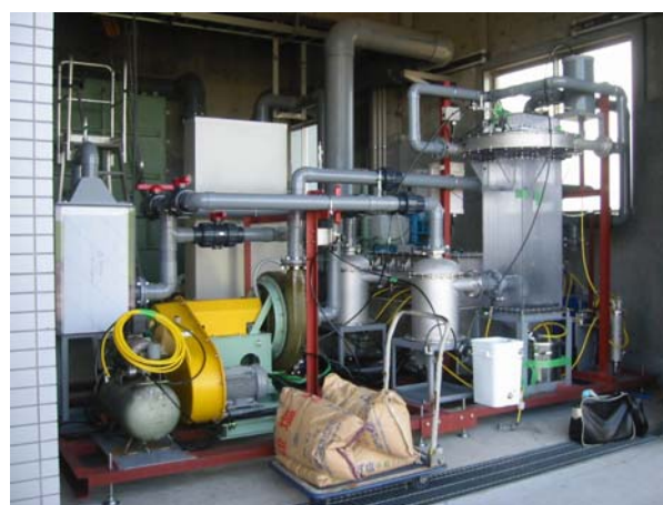
図2. 新方式脱臭装置のパイロット機
