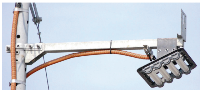
図4 設置状況の写真
