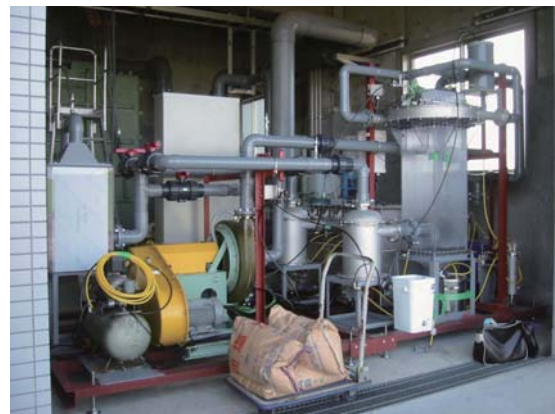
図2. 新方式脱臭装置のパイロット機
